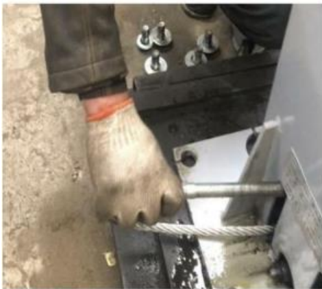
Fig7-1 El cable a través de los pilares hacia atrás
